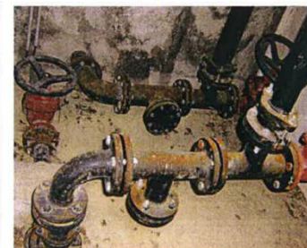
Chambre à vannes
